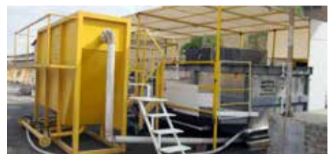
پکیج سیستم انعقاد الکتریکی در مقیاس صنعتی در شهرک صنعتی چرم شهر
